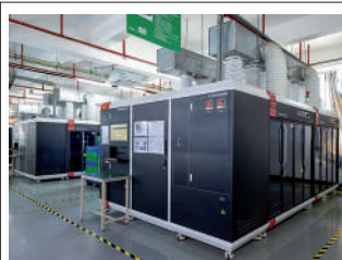
Встроенные испытательные установки
